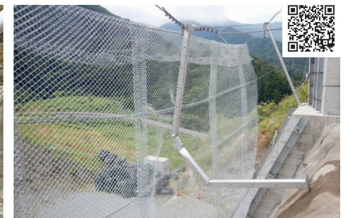
支柱破損状況
