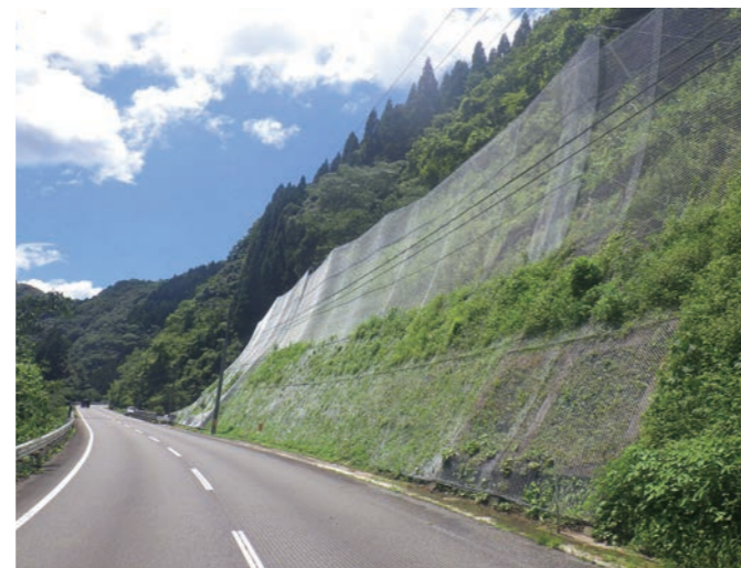
工事名：令和2年度 緊急国法第52-8-1号 国道327号 枝の崎工区 道路防災工事 発注者：宮崎県日向土木事務所
