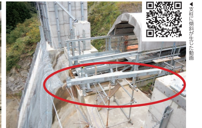
補修しなければ性能(捕捉性能)に影響を及ぼす
