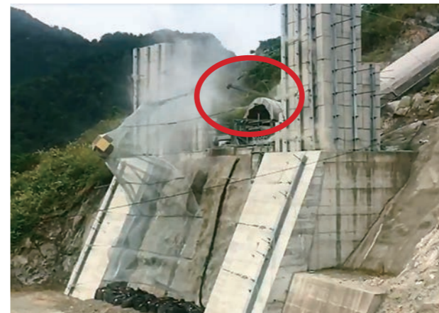
支柱に有意な傾斜が発生した事例
